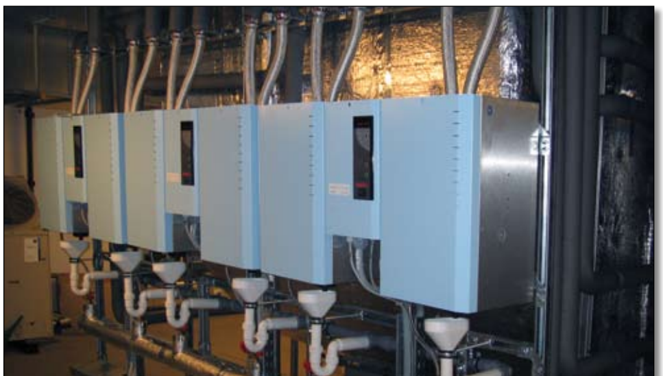
Kaut Befeuchtung: Stadtwerke Düsseldorf
