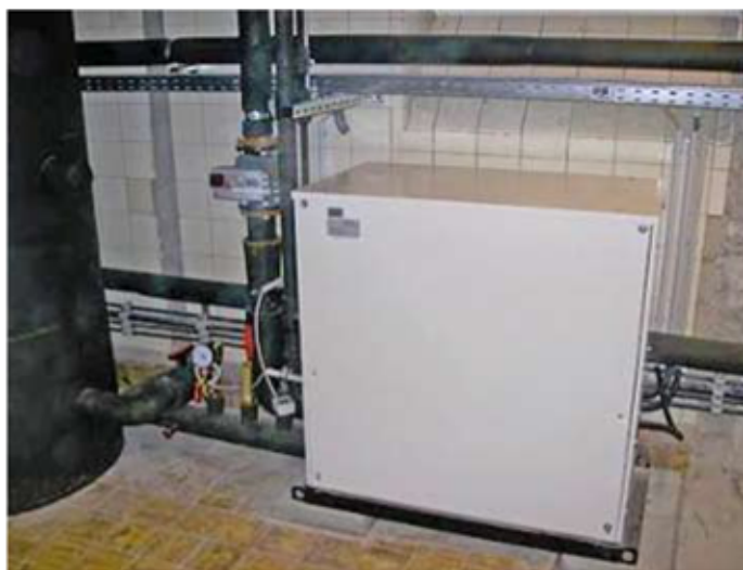
Bild 5: Wassermodule zur Kaltwassererzeugung für die Kühlung der Tomographen.
