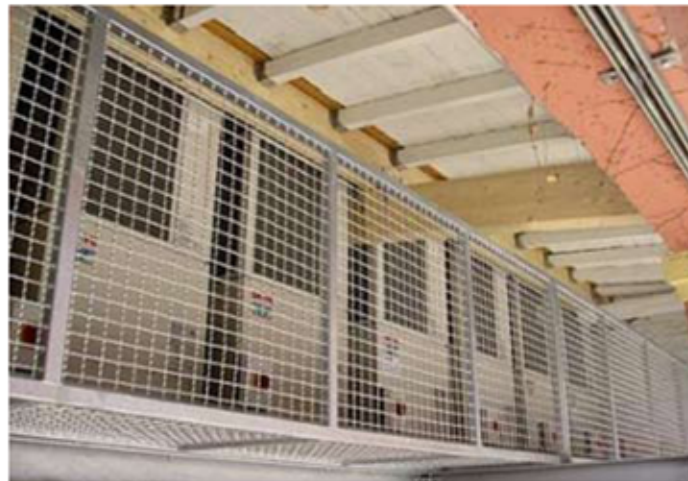
Bild 2: Aufstellung der VRF-Außeneinheiten mit Luftausblas über Dach.
