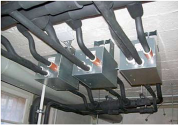
Bild 6: Installation der 3-Way-Umschalt-einheiten im Technikraum des Hauptgebäudes.
