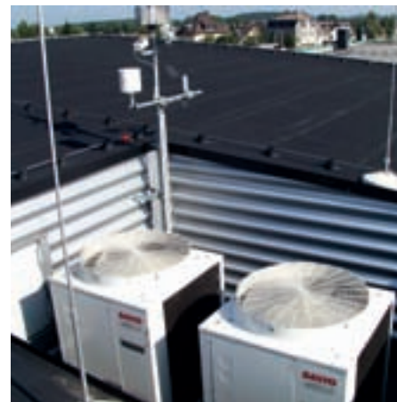
Sichtbar auf dem Dach untergebrachte Außen-einheiten
