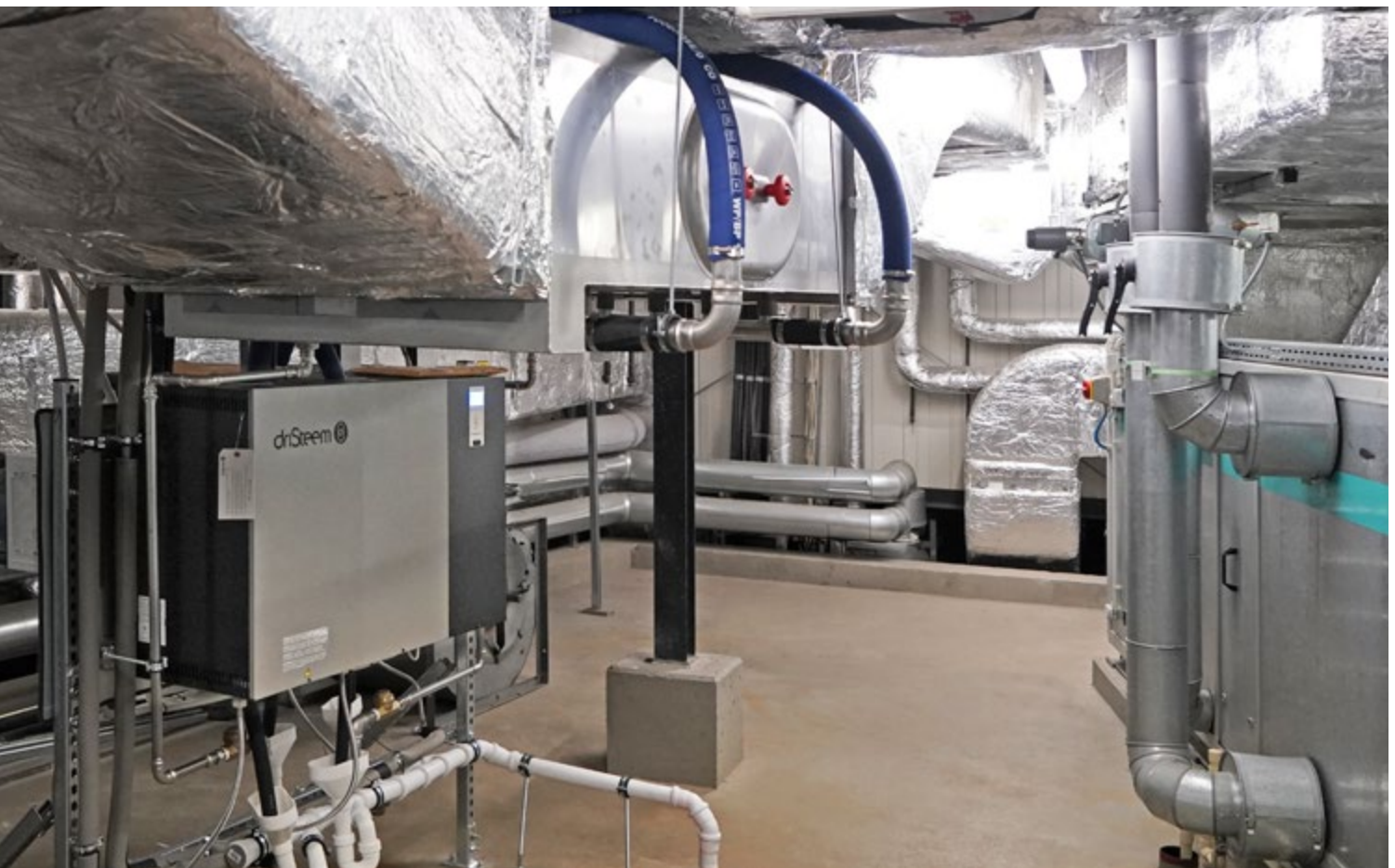
Effiziente Luftbefeuchtung im Einsatz: Die neuen Elektrodampfbefeuchter von driSteem sorgen für ein konstantes Klima.
