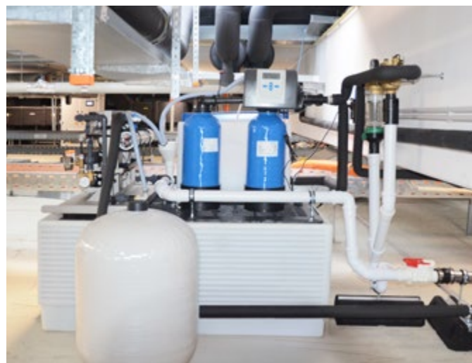
Pendelenthärtungs- und Umkehrosmoseanlage reduzieren den Wartungsaufwand erheblich
