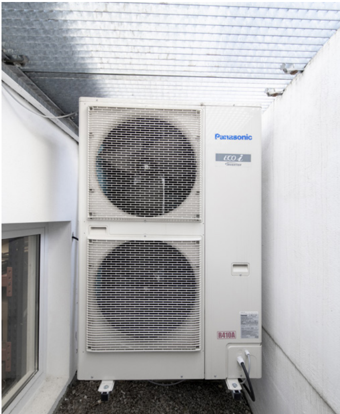
Fast unsichtbar: VRF-Außeneinheit in Lichtschacht aufgestellt
