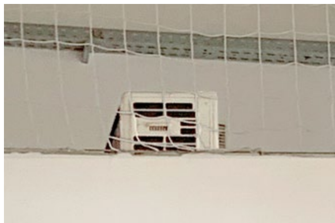
Das Ballschutznetz bewahrt die Technik vor Beschädigungen während des Sportunterrichts
