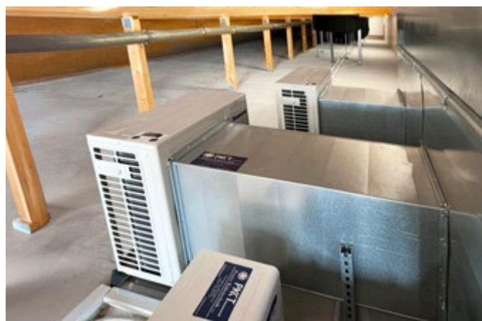
Direkte Anbindung der Außengeräte an das Abluft-Kanalsystem zur sicheren Wärmeabfuhr unter dem Dach
