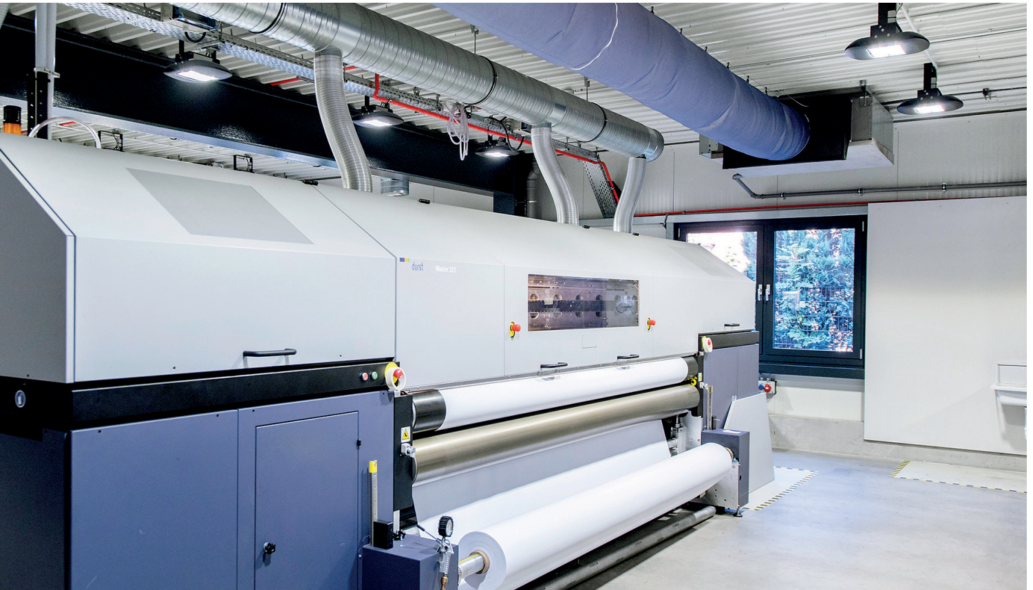
Kaum wahrnehmbarer Lufteintritt über Textilschläuche in einer Druckerei
