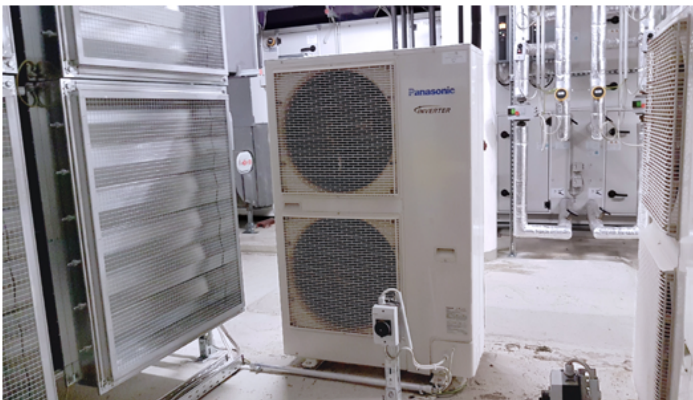
Jedem Außengerät ist ein Ventilator mit Jalousieklappe zugeordnet, die bei Anforderung in Betrieb geht.
