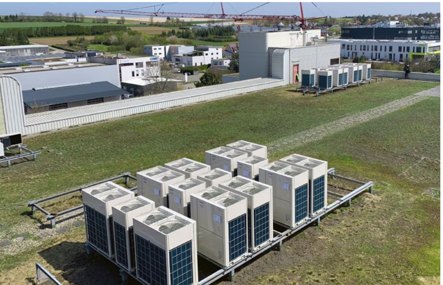
31 auf dem Dach montierte VRF-Außeneinheiten von Panasonic
