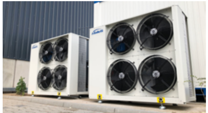
MPE027C Zwei Geräte mit je 30 kW Kälteleistung
