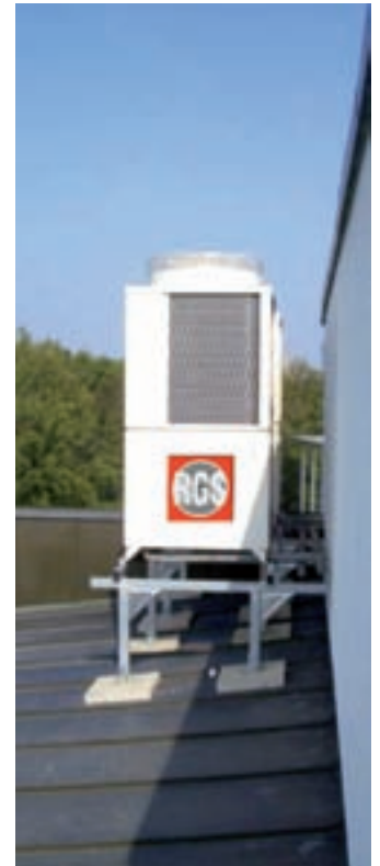
Die optimal montierten Außeneinheiten.
