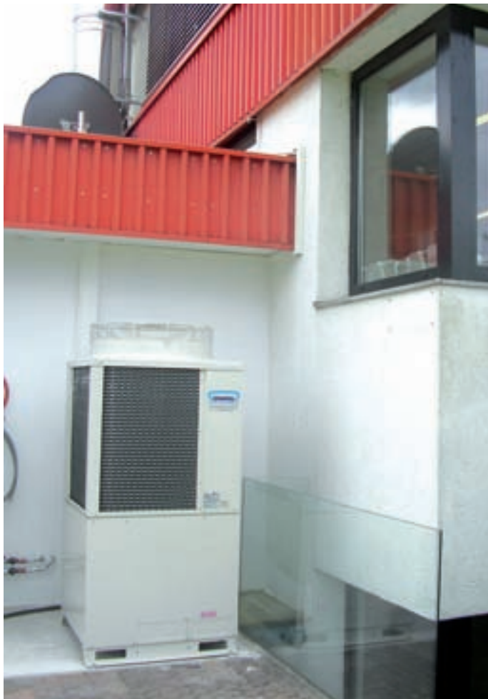
Diskret untergebracht: Außengerät von Kaut/Sanyo.
