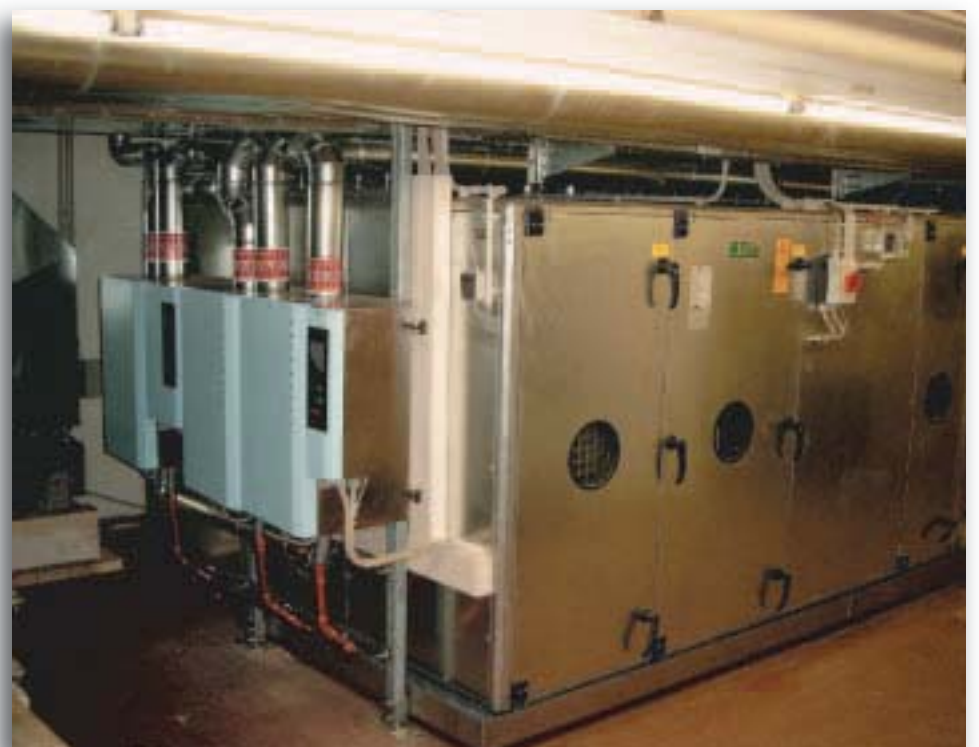
Die beengten Platzverhältnisse bei der Sanierung der Klimaanlage ließen nur ein Produkt zu: Die kompakten Dampfluftbefeuchter von Kaut.
