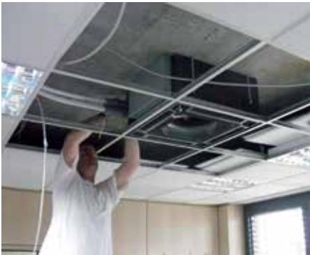
Einbau einer RAI 25 Hitachi Inneneinheit in die Euro-Rasterdecke eines Büroraums
