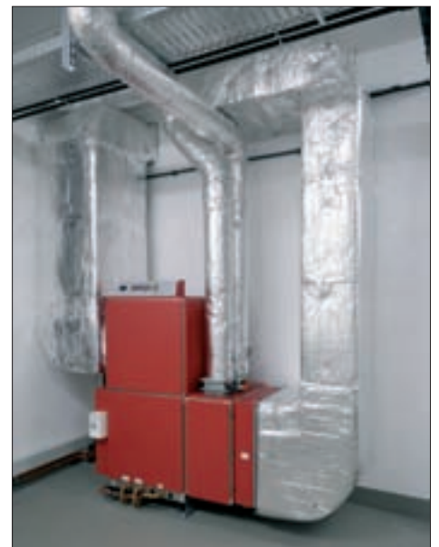
Das ist der Variheat (AA600). An der Konsole können Temperatur und Luftfeuchtigkeit reguliert werden.
