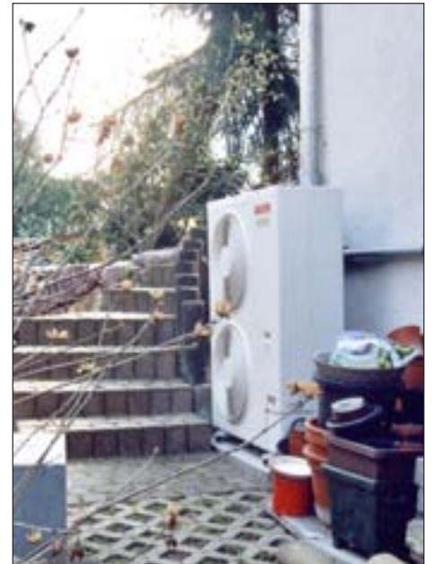
Die Außeneinheit ist hinter dem Haus gut platziert.
