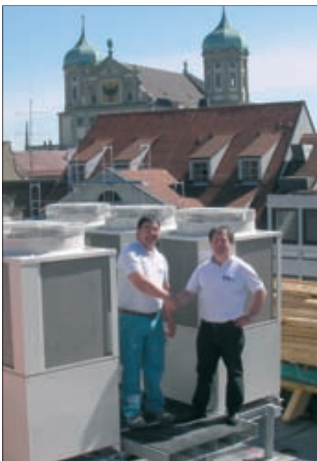
Außengeräte von Kaut/Sanyo vor der Kulisse von Augsburg.
