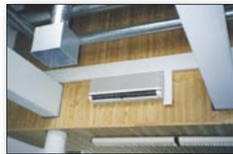
Eines von insgesamt 23 Innengeräten.
