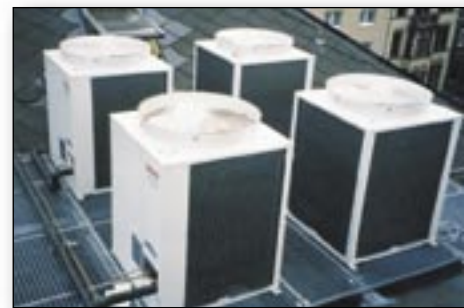
Vier Außeneinheiten bei 150 kW Kühlleistung.
