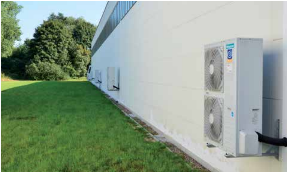
PAC-Außeneinheiten, Gesamtkühlleistung 146 kW
