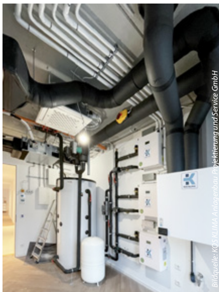
Drei PACi Hydromodule sorgen für eine exakte Temperaturführung des MRT-Bereichs
