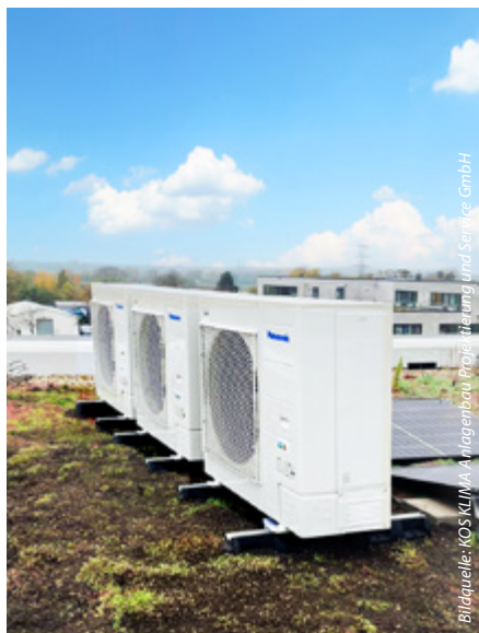
PACi NX Elite Außeneinheiten von Panasonic auf dem Dach des Gesundheitszentrums
