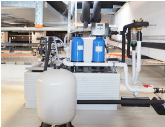
Pendelenthärtungs- und Umkehrosmoseanlage reduzieren den Wartungsaufwand erheblich
