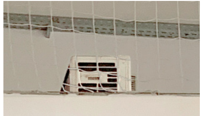
Das Ballschutznetz bewahrt die Technik vor Beschädigungen während des Sportunterrichts
