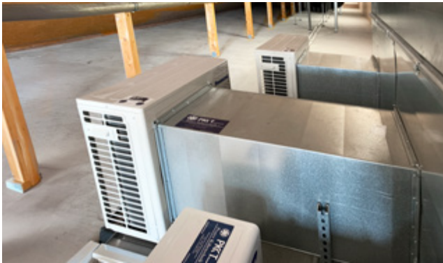
Direkte Anbindung der Außengeräte an das Abluft-Kanalsystem zur sicheren Wärmeabfuhr unter dem Dach
