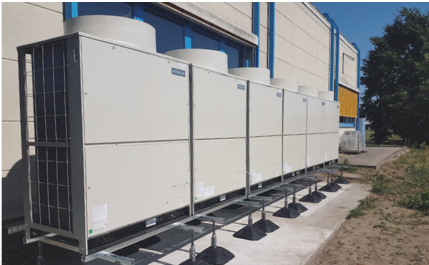
Bildquelle: Yves Schirmer Kälte-Klima-Wärmepumpen
