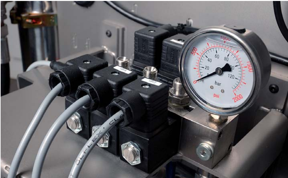
Magnetventilbaugruppe eines Hochdruckdüsenbefeuchters zur Leistungsregelung
