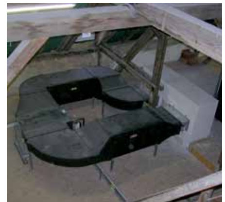
Das im Dachboden installierte Kanalgerät
